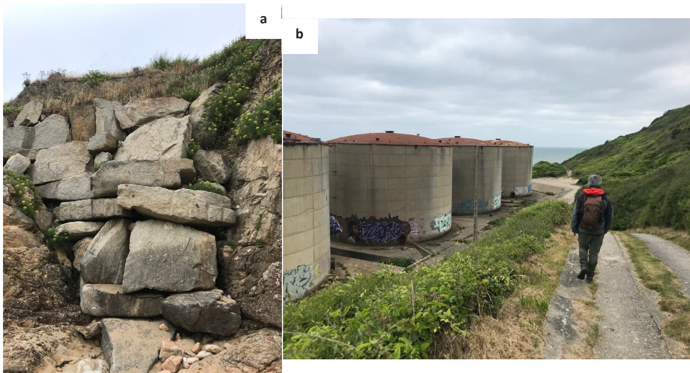
Figure 33. Exemples d'atteintes quantifiables en surface : (a) enrochement et (b) routes bétonnées et bâtiments (photos : J. Boulet).
