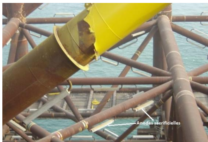
Figure 34: Anodes sacrificielles sur la structure métallique d'une fondation jacket (© Armando-Martin ; Wikimedia commons)
