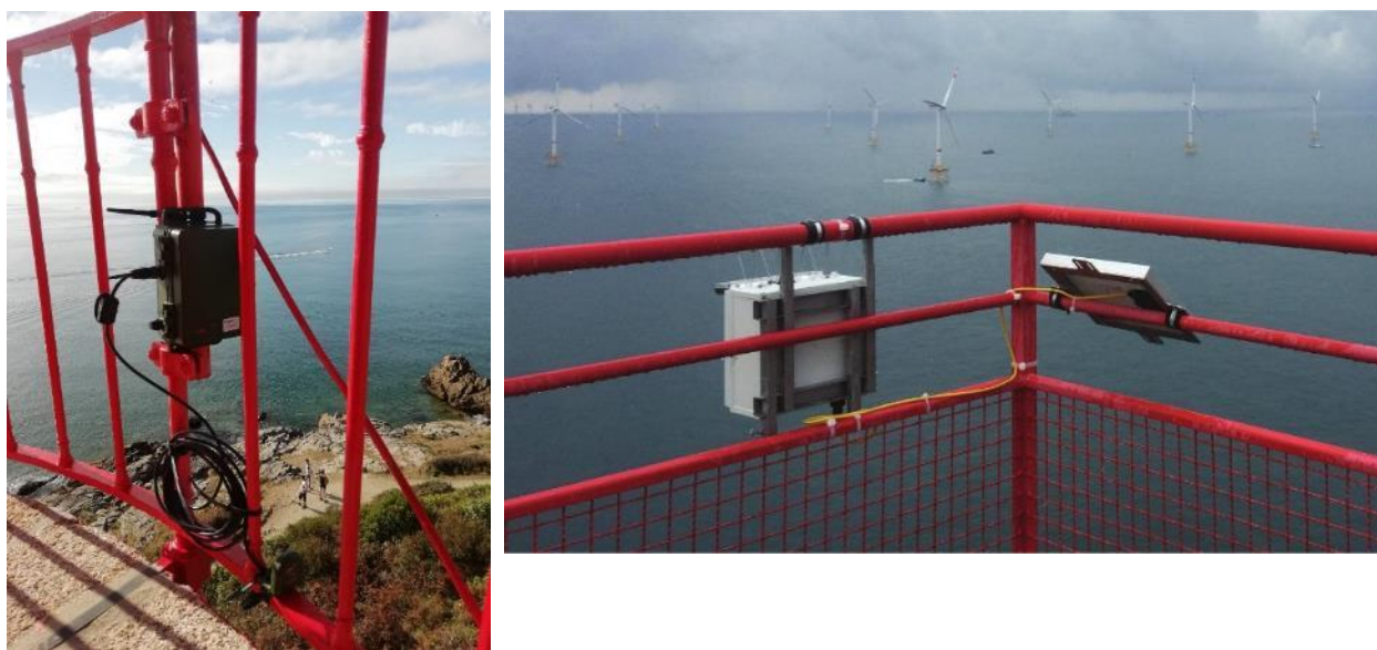
Figure 92 : (Photo de gauche) Batcorder SM4 installé sur le phare de Port Manec'h (©Emmanuelle Cabon – Phares & Balises) ; (Photo de droite) Batcorder installé sur la plateforme de treuillage pour hélicoptère à l'arrière de la nacelle d'une éolienne (Brabant et al., 2020)
