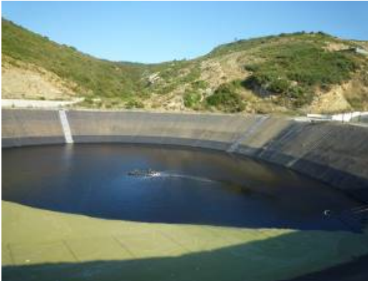
Figure 38 - Exemple : Bassin bâché avec des berges très abruptes, mais équipé d'un dispositif de type « échappatoire à faune » (en clair, au fond) © O. Delzons
