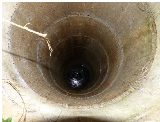
Figure 41 - Exemple : puisard en béton piégeant pour les Grenouilles rouges © O. Delzons
