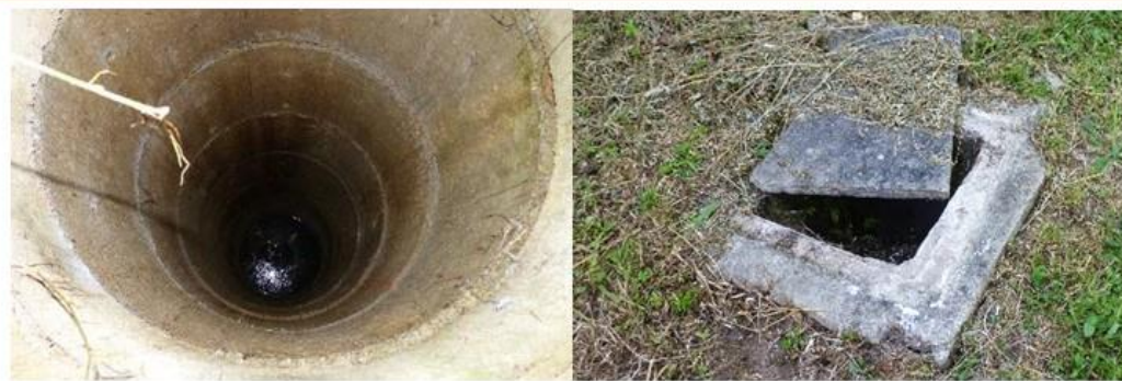
Figure 30 - Puisard en béton © O. Delzons / Regard ouvert © A. Lacoeyllhe
