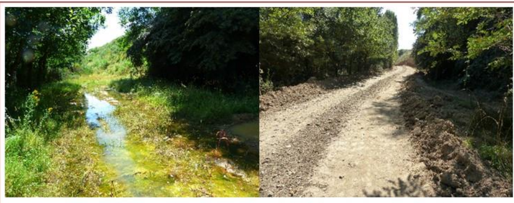
Figure 32 - Destruction d'une ornière végétalisée et riche en biodiversité, suite à la réfection d'une piste © O. Delzons
